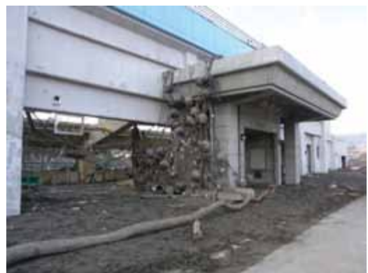
写真-3 RC建物の被災事例(野球場) (宮古市湾奥部：周辺での浸水深は地盤から4.3m)
