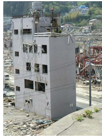
写真-6 転倒を免れたRC建物の例(宮城県女川町)
