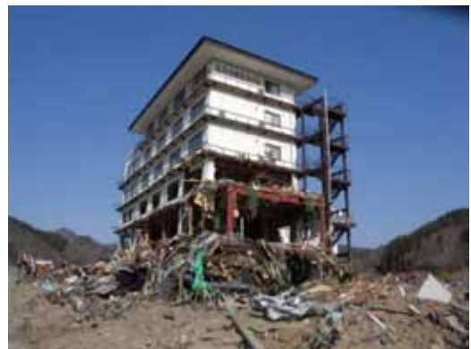
写真-2 S造建物の被災事例(宿泊施設) (宮古市田老：周辺での浸水深は地盤から11.7m)
